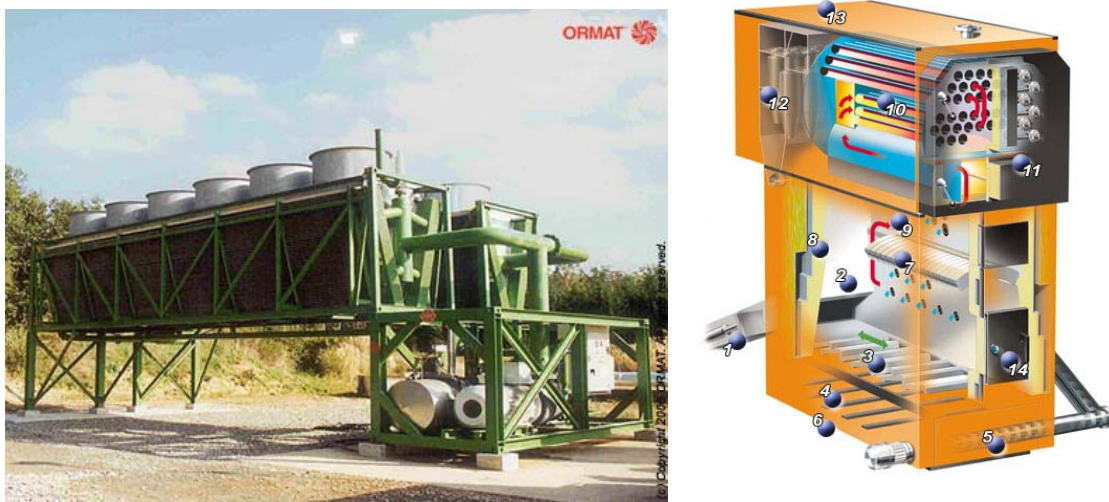
Figure 4: Centrale ORC de Bad Blumau, avec refroidissement à air.
